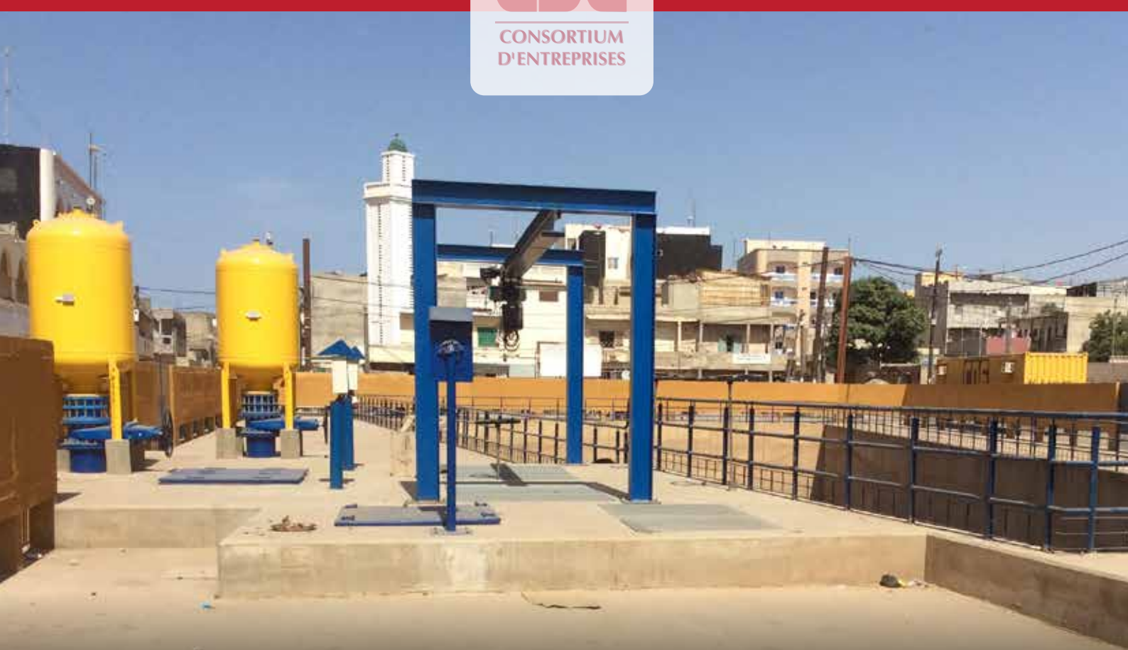
Station d'épuration des eaux pluviales GRAND YOFF (SÉNÉGAL)
