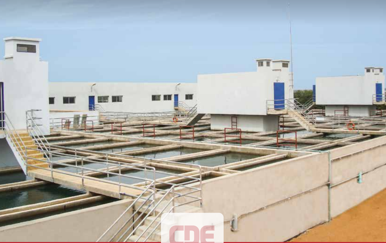
Station de traitement d'eau potable (SÉNÉGAL)
